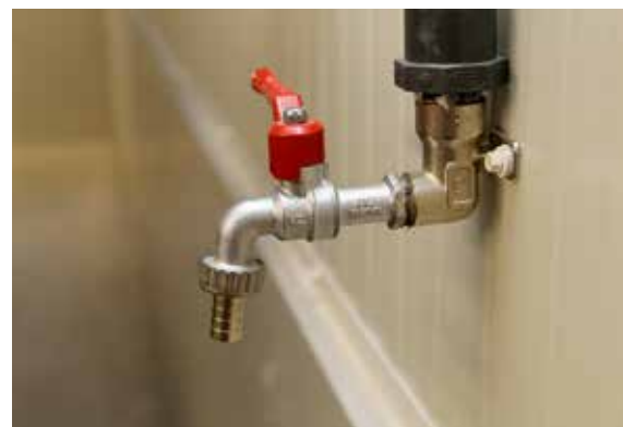
RENSLIGHET: En vannkran på veggen ved dørene mellom avdelingene gjør det enkelt å spyle gummistøvleene.
